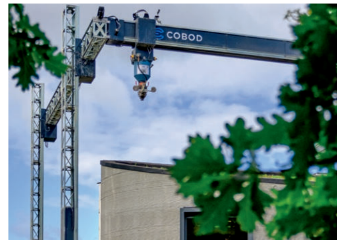
Das Niedrigenergiehaus ist funktional eingerichtet und kann vielfältig genutzt werden ( oben links ). Die additive Bauweise sorgt für ein optisch ansprechendes Wanddesign. ( oben rechts ). Bei den Bauarbeiten kam Europas größter 3D-Betondrucker zum Einsatz ( links ).
